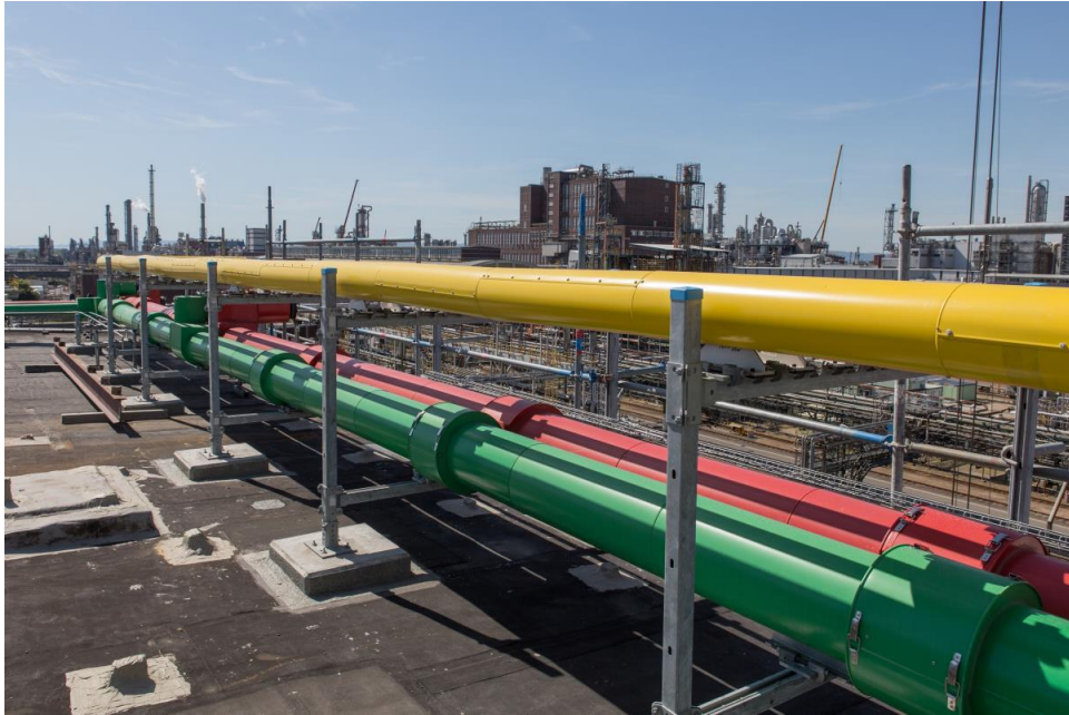
Halterung der Dampf- und Kondensatleitungen durch HALFEN Powerclick. Foto: BASF
