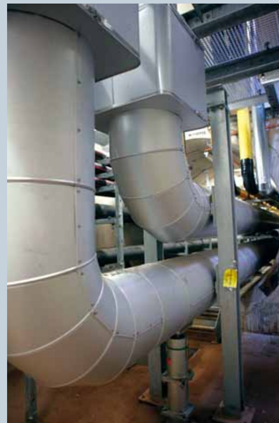
Blick in das Schachtbauwerk mit der Einmündung der mächtigen Fernwärmeleitungen aus der Vertikalen in den Infrastrukturkanal.
